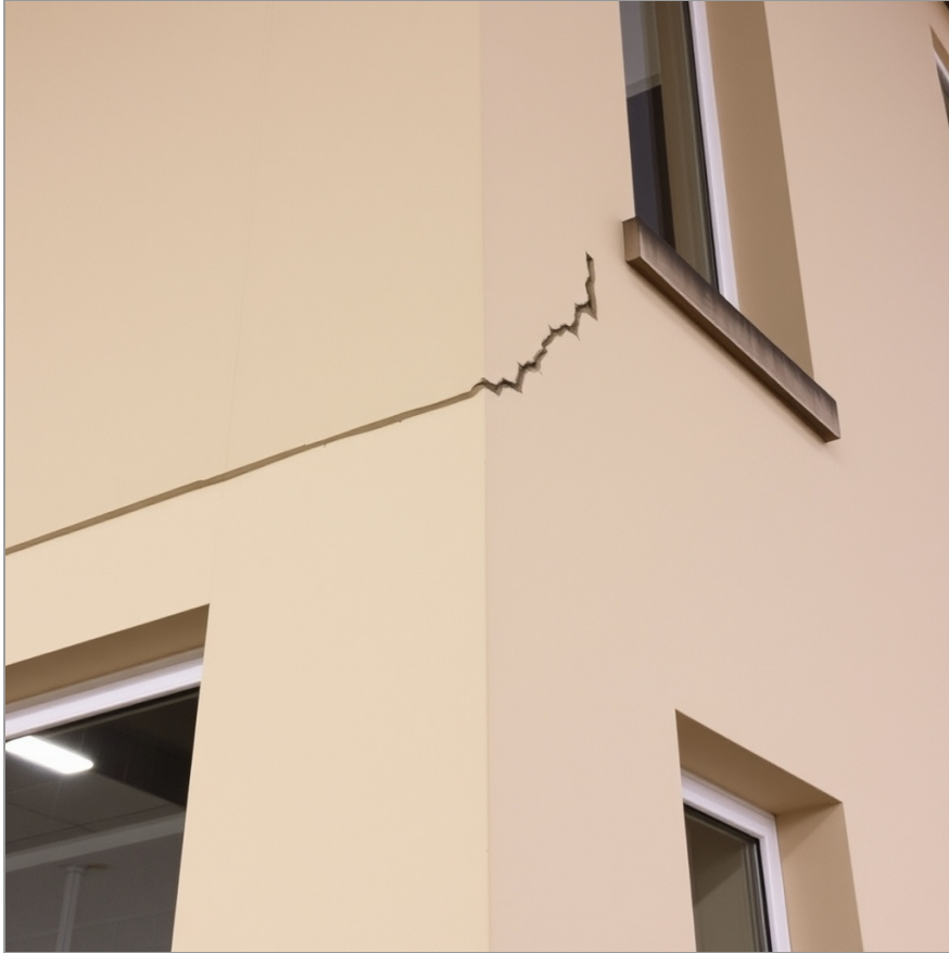
Dokumentierte Fehlstelle an der Fassade, Detail
