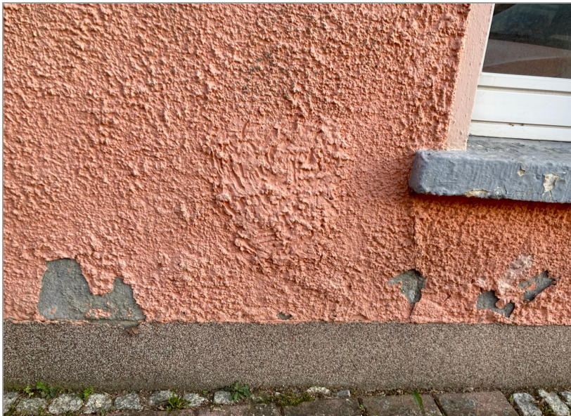
Sockelzone mit zu niedrig endender Abdichtung
