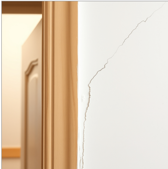
Nachzuarbeitende Anschlussfuge an der Türleibung
