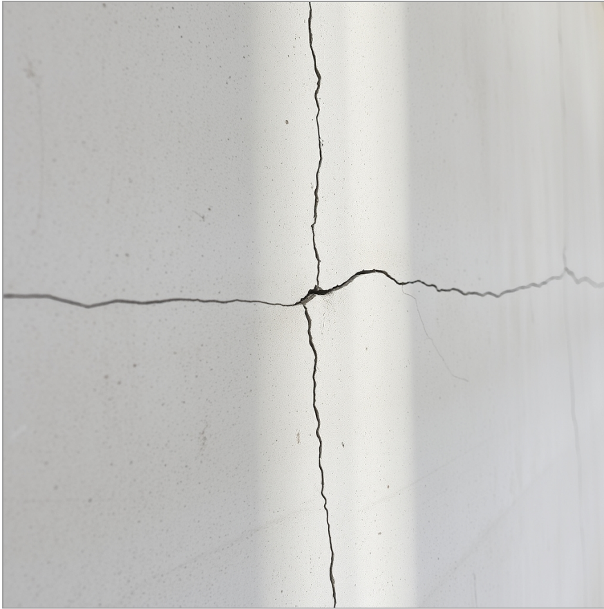
Rissbild an der Attika, Streiflichtaufnahme
