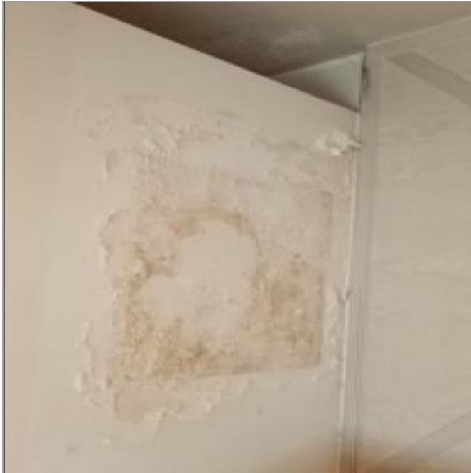
Salzausblühungen an der erdberührten Wand
