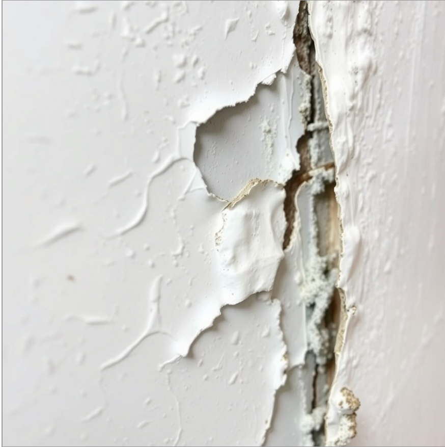
Anstrichblasen an der Kellerwand
