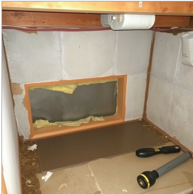
Öffnung am Bodenaufbau, feuchte Randzone
