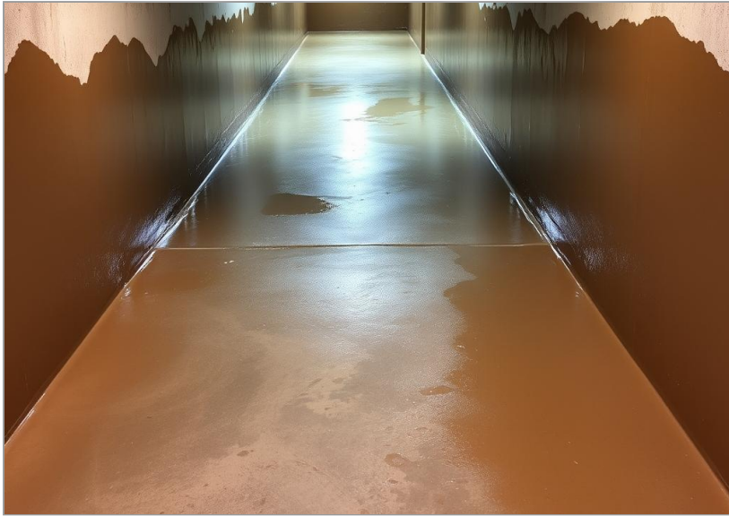
Feuchtehorizont mit freigelegtem Sockelbereich
