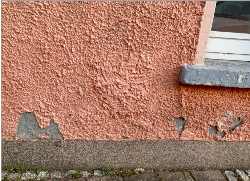
Abplatzender Sockelputz an der Wetterseite
