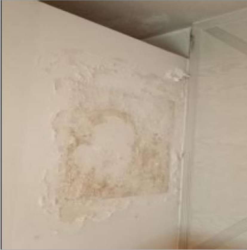
Salzbelastetes Sockelmauerwerk, Detail
