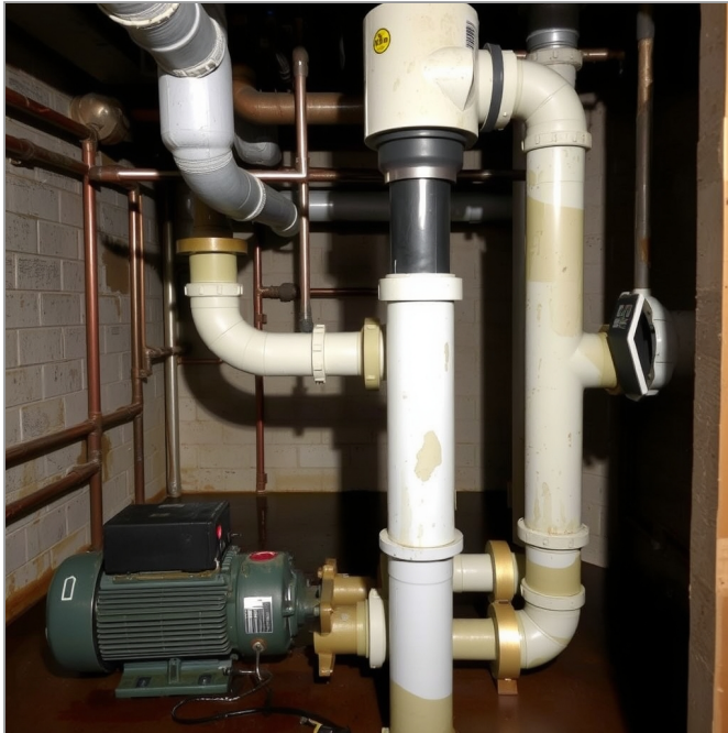
Installationsebene nach Öffnung der Revisionsklappe
