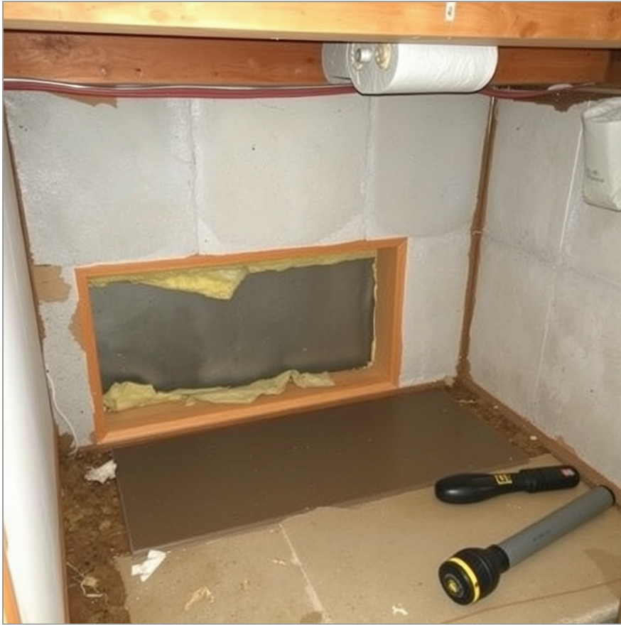
Bohrsondierung/Öffnung am Estrichrand, durchfeuchtete Dämmlage
