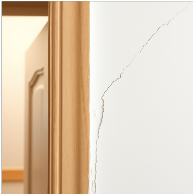
Diagonalriss über dem Türsturz, Wohnung 2. OG
