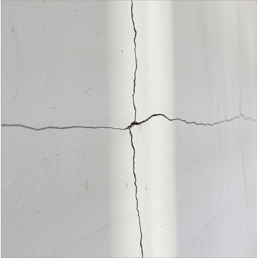
Rissbild mit Streiflicht, Messstellenbereich
