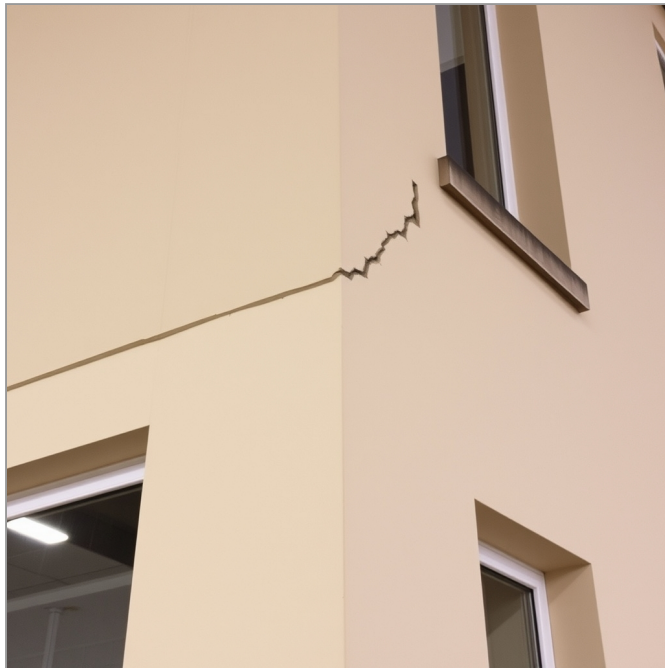
Setzriss am Fenstereck der Straßenfassade
