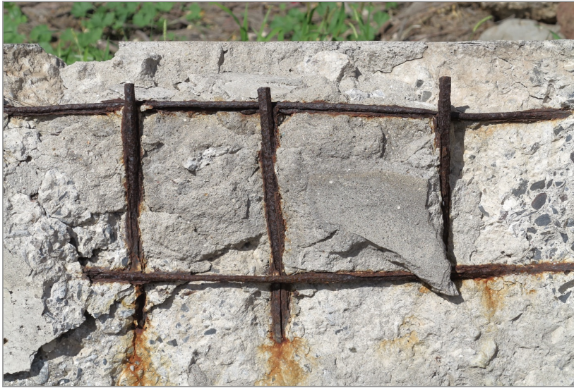
Abplatzung mit freiliegender korrodierter Bewehrung
