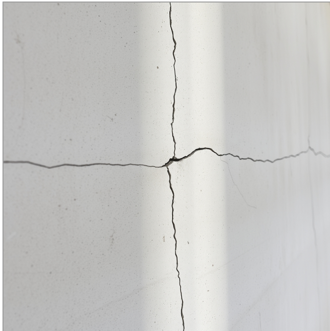
Rissbild in der Beschichtung, Streiflicht
