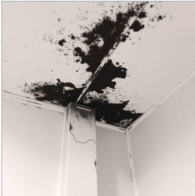
Befall in der Raumecke, Klassenraum 1.03
