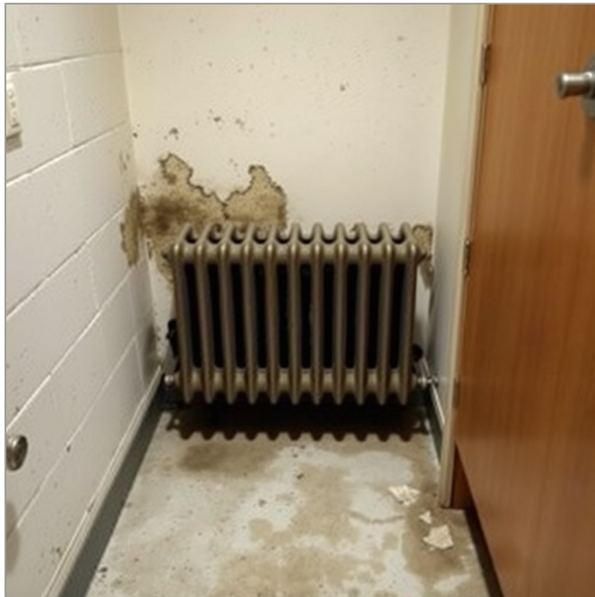
Befall am Wandanschluss vor der Beseitigung
